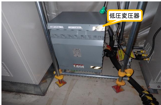
(写真3) 平成30年当時異常が発生した低圧 変圧器
