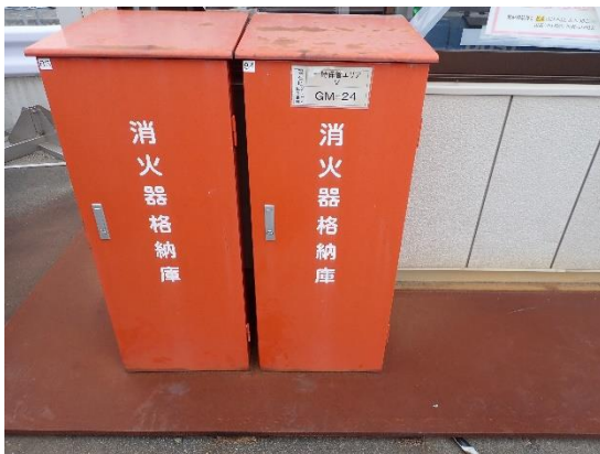
(写真2-3) 消火器の設置状況
