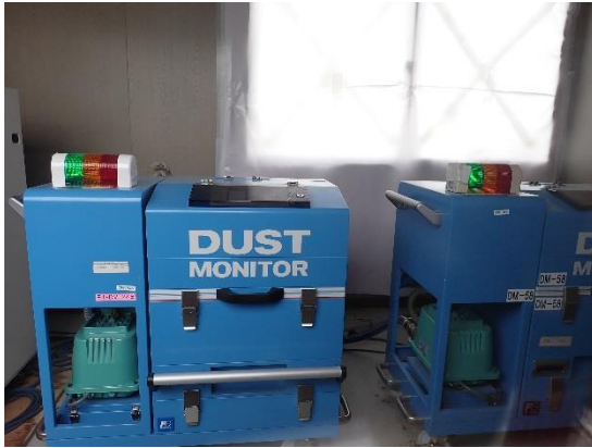
(写真1-3) プレハブ小屋内における構内ダスト モニタ2台（3、4号機西側法面） の設置状況
