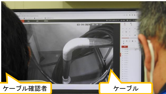
(写真2-2) へび型ロボットケーブルの状況
