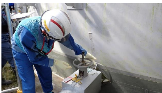
(写真1) C1タンク出口弁（ゲート弁）の開 操作の状況
