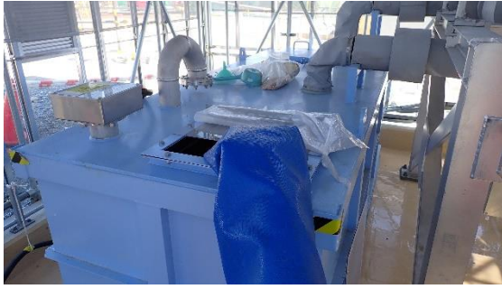
(写真3) 処理水移送受けタンクの状況
