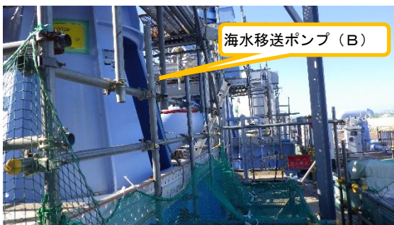
(写真2-2) 海水移送ポンプ(B)の状況
