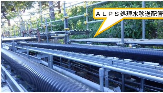
(写真1) ALPS処理水移送配管の状況
