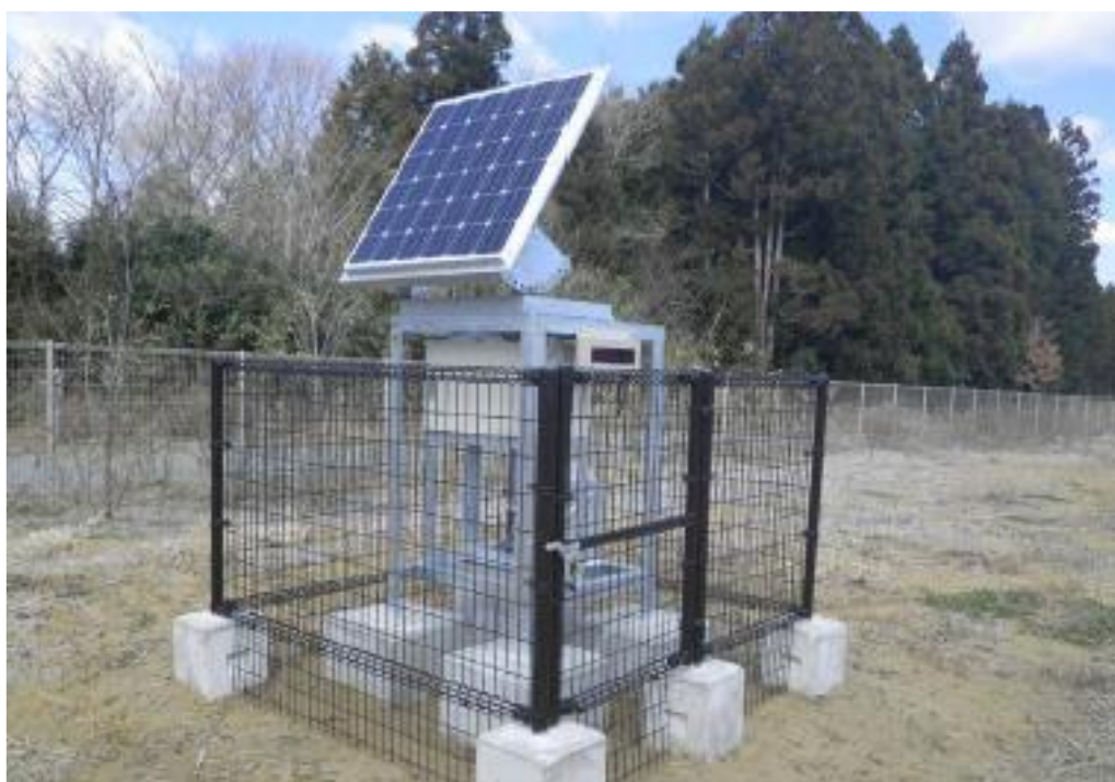
可搬型モニタリングポストの外観
