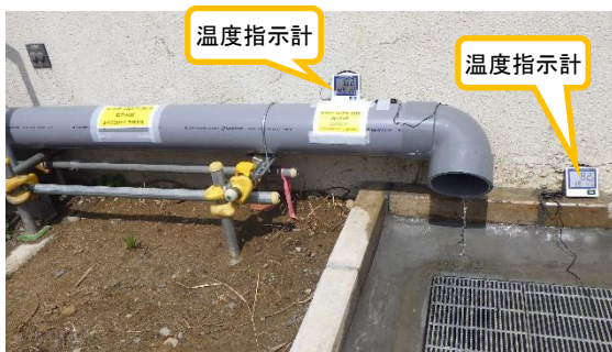
(写真 3 - 2) 仮設雨水排水管流末の状況 (南側から撮影)
