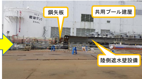
(写真1-2) 鋼矢板設置場所周辺の概観② (今回(4月6日)南東側から撮影)
