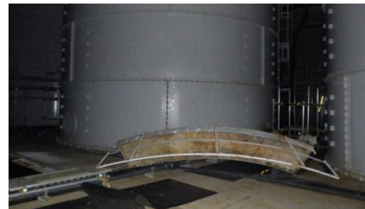
フランジタンク歩廊落下
