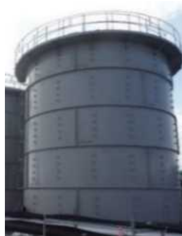
フランジ型タンク
