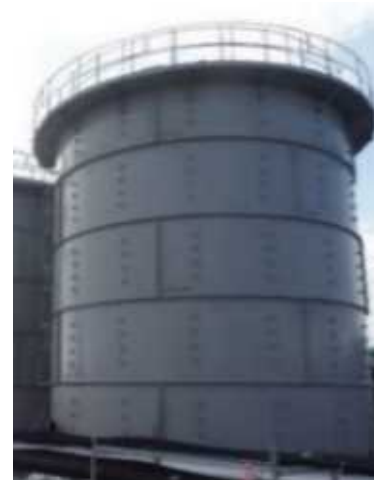
フランジ型タンク
