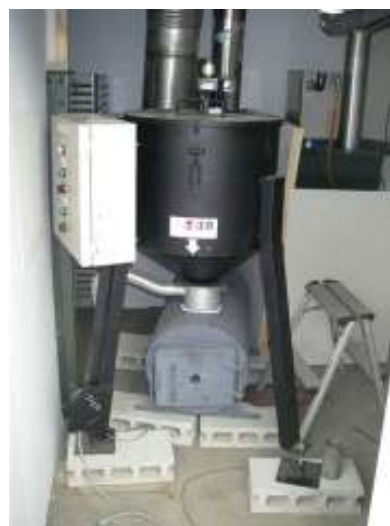
ペレットボイラー設置状況
