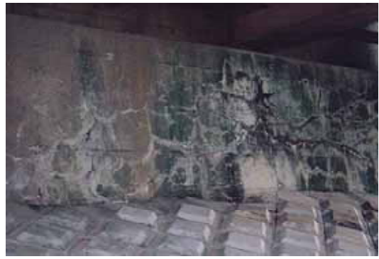
橋台のひび割れ状況(詳細調査実施)
