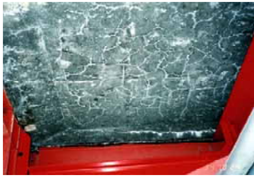
床版のひび割れ状況(詳細調査実施)
