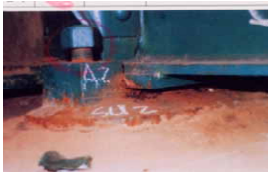
ボルトのゆるみ(維持工事対応)
