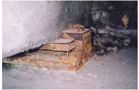
支承の錆状況(詳細調査実施)
