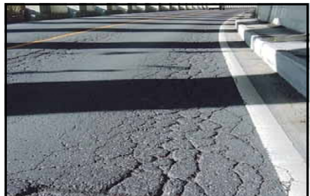
図2-6 ひび割れ状況 ( (一) 猪苗代湖南線 )
