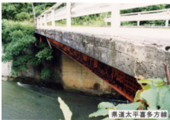
橋梁劣化状況
