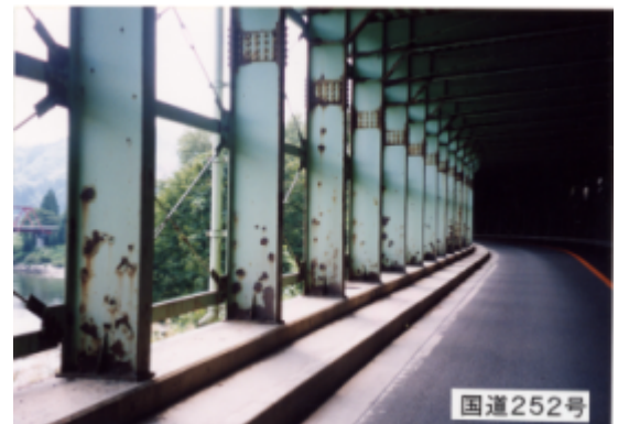
スノーシェッド劣化状況
